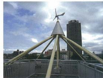
東京都練馬区立光和小学校 （定格出力 300W×3 基）
