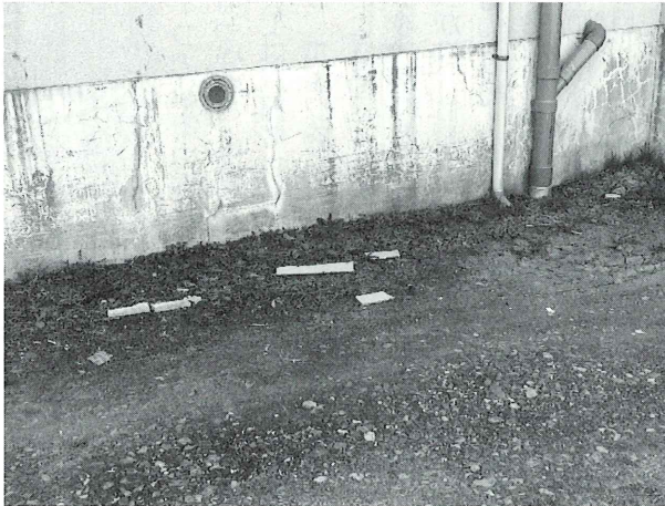
強風等によりコンクリートが剥がれ落ちている (消防アパート)
